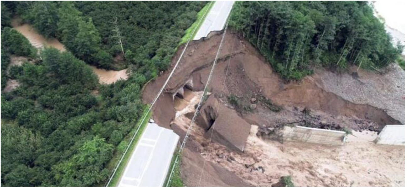
Şekil 1 Sel nedeniyle Tirebolu-Doğankent yolunda çöken ve kurtarma çalışmalarına giden 5 jandarmanın içerisinde bulunduğu aracın suya gömüldüğü menfez. Bu menfezin alt kısmındaki çakıl ve kum, ocak işletmecileri tarafından yıllardır alınınca menfezin alt kısmı da boşalmış. Menfezin kapasitesi aşırı yağış sonucu kısa sürede oluşan ekstrem akımı geçirmekte yetersiz kalmıştır.
